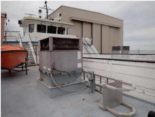
Non mini split HVAC Unit
