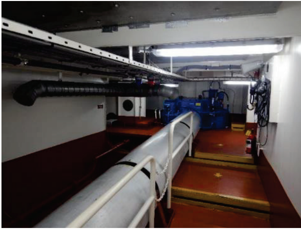
Shaft area for Voith unit
