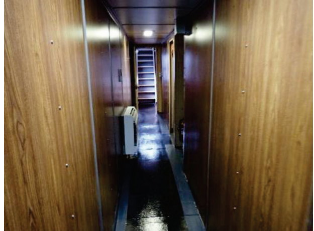
Mini split in passageway
